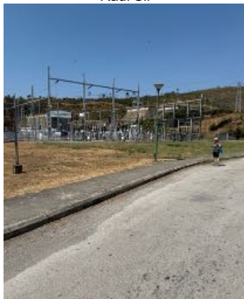
Stație de transformare a hidrocentralei
